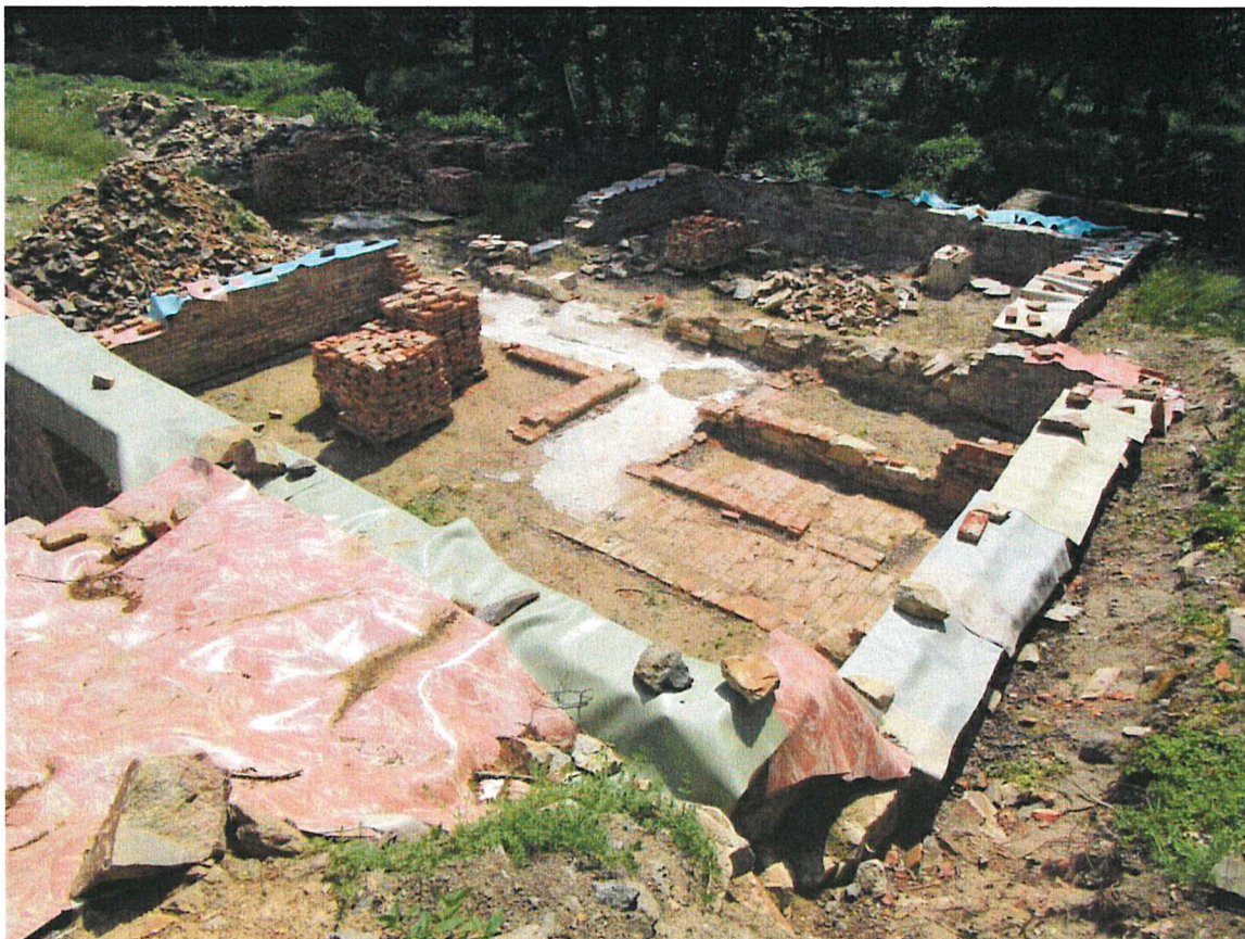
Habermühle, odkryté základy zbořené budovy mlýna připravené pro plánovanou rekonstrukci (foto Z. Procházka 2018)
