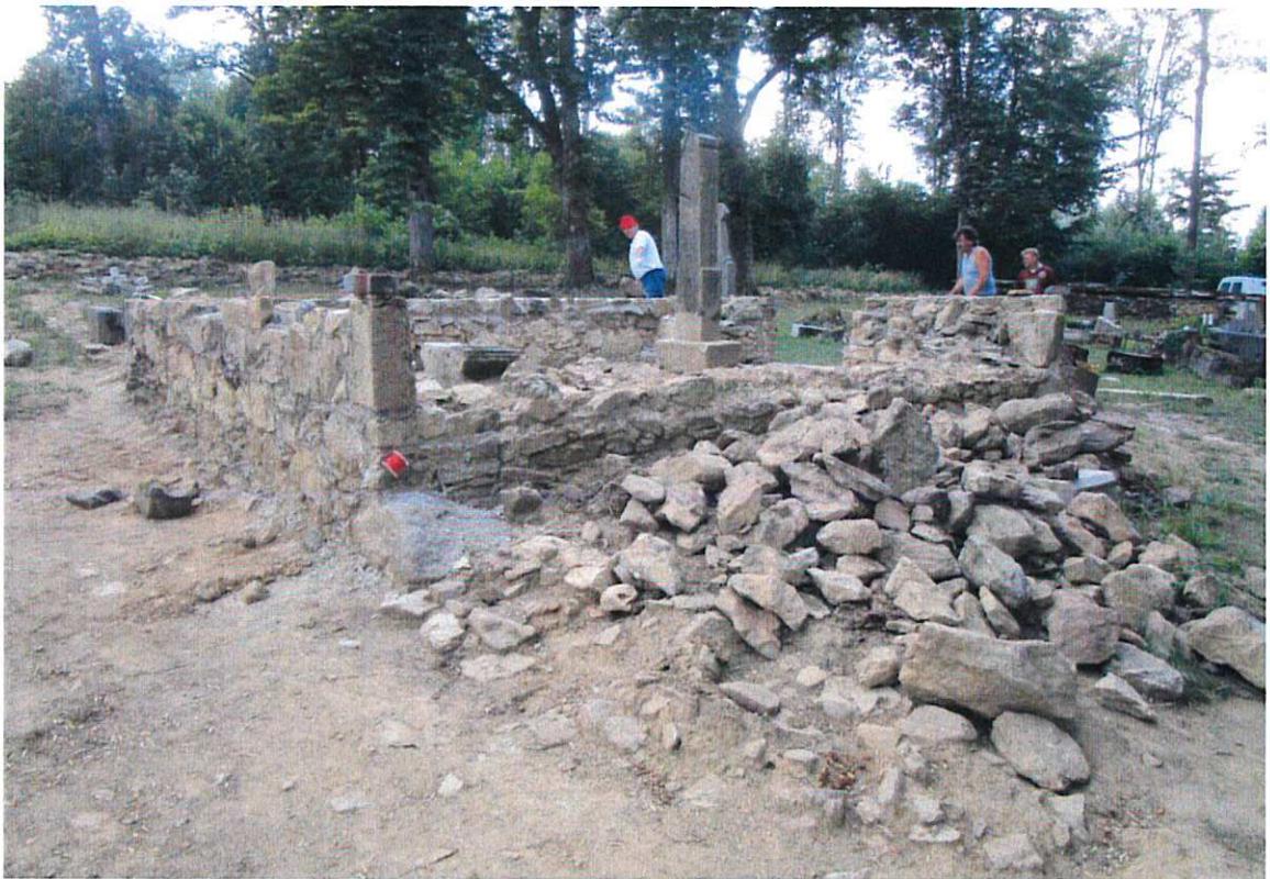
Lučina, starší část hřbitova, pohled na opravu základů zničené hřbitovní kaple (foto Z. Procházka 2018)
