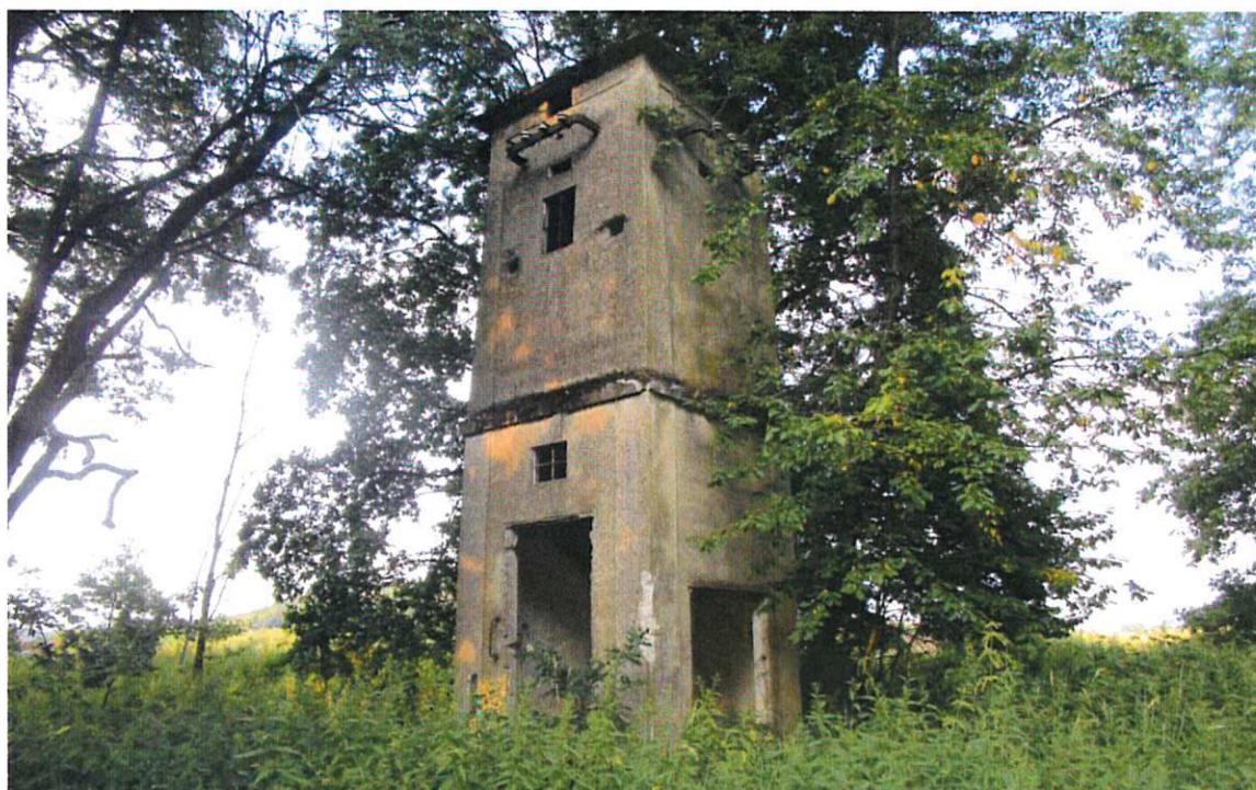
Myslív, starý transformátor na okraji zaniklé vsi (foto Z. Procházka)
