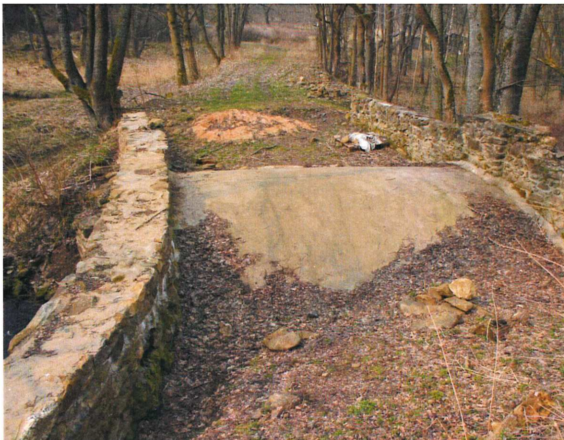
Mostek, historický most poškozený těžkou technikou při první nezdařené opravě v roce 2009 (foto Z. Procházka)
